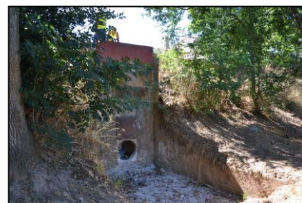
Photo 10. Clapet anti-retour situé allée des Ombres. Prise de vue dans le lit majeur du Gapeau. Quartier de l'Oratoire. (26/08/15 ©E.G.)
